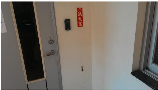
說明：滅火器缺少處理前。
