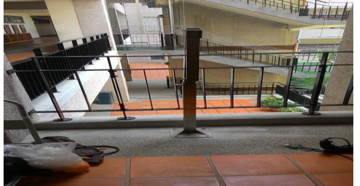
說明：緩降機支架位移後。
