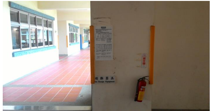
說明：避難器具操作說明處理後。
