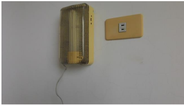
說明：照明燈故障處理前。
