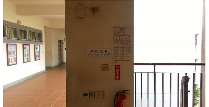
說明：避難器具標示牌處理後。
