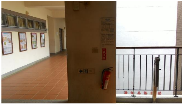
說明：避難器具標示牌處理前。
