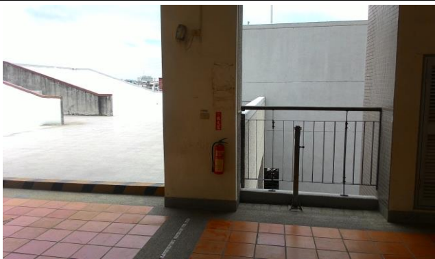
說明：避難器具標示牌、操作說明處理前。
