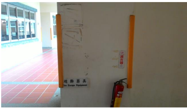
說明：避難器具操作說明處理前。
