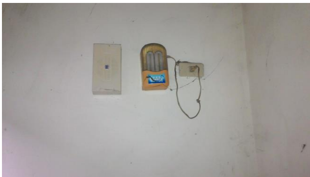
說明：照明燈故障處理前。
