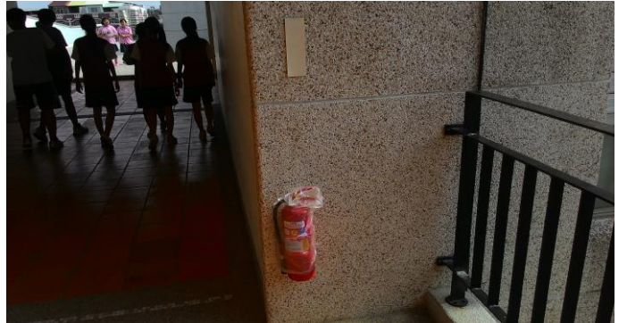
說明：滅火器缺少處理後。
