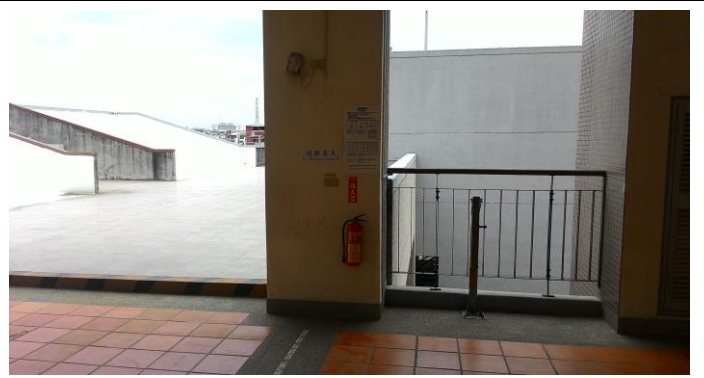
說明：避難器具標示牌、操作說明處理後。
