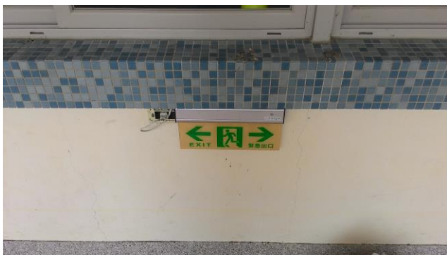
說明：避難方向指示燈修繕前。
