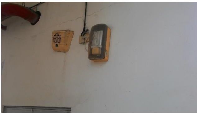
說明：照明燈故障處理前。
