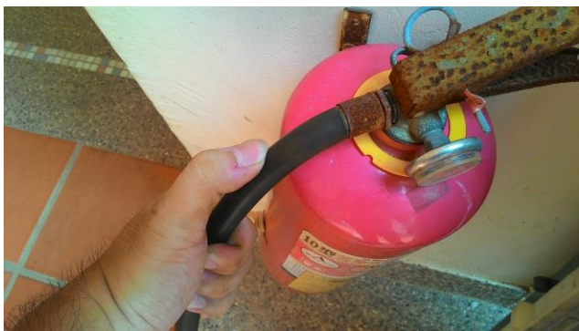
說明：滅火器皮管鏽蝕處理前。
